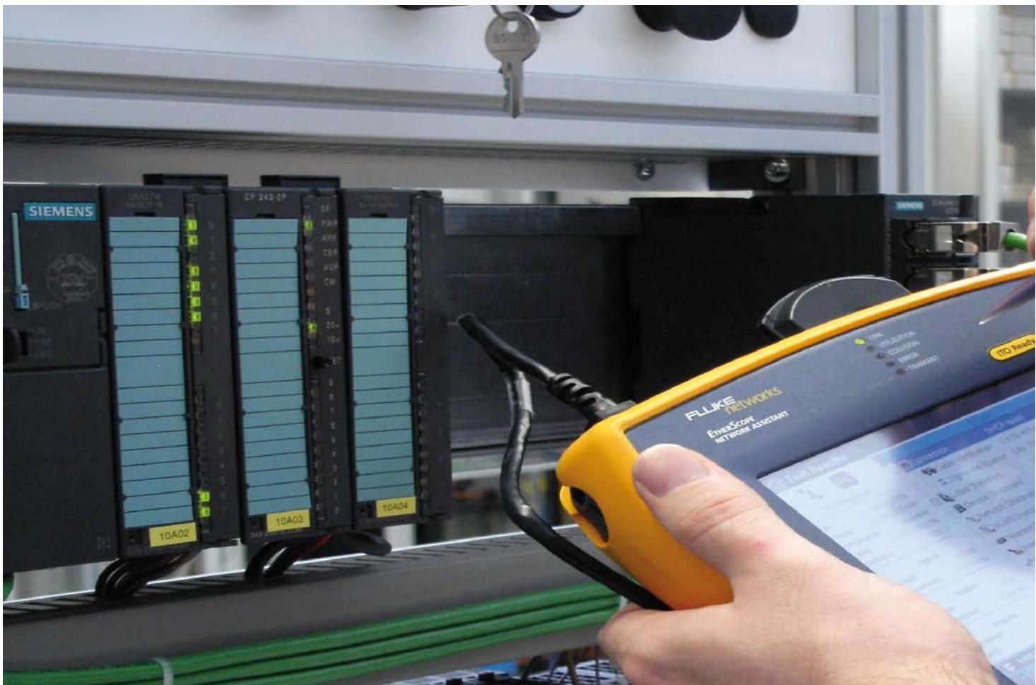
Prüffeld für Industrielle Kommunikation und IT-Sicherheit
